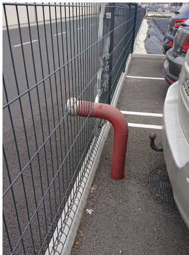
Figure 6 : Raccord pompier de la réserve incendie enterrée
